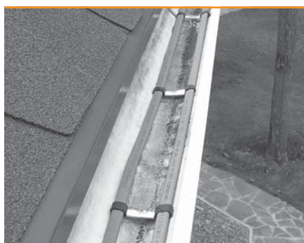
6 водосборные лотки (водосборные желоба)
